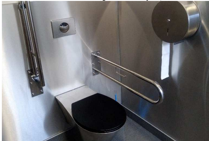
Antivandal provedení vnitřního vybavení.
